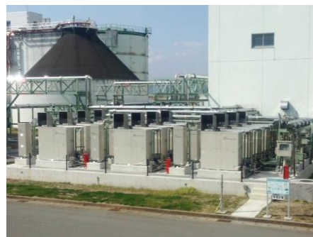
山形浄化センター
