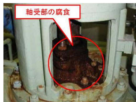
ポンプ設備の腐食
