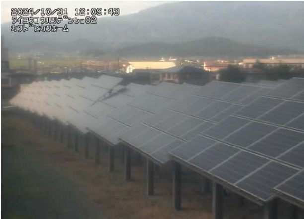
令和6年10月30日 12:09 太陽光発電所の状況
