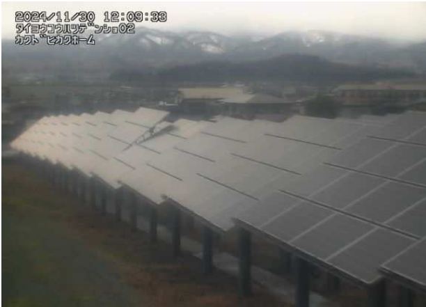
令和6年11月30日 12:09 太陽光発電所の状況
