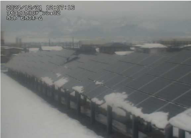
令和6年12月31日 12:07 太陽光発電所の状況
