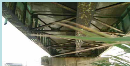
塗装の劣化による桁の腐食
