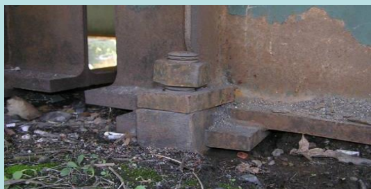
雨水の浸水による支承の腐食
