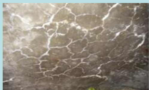
格子状の床版ひびわれ(疲労)
