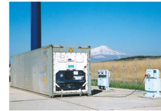
冷凍(リーファー)コンテナとリーファーコンセント 電源設備使用料 31円/kwh
