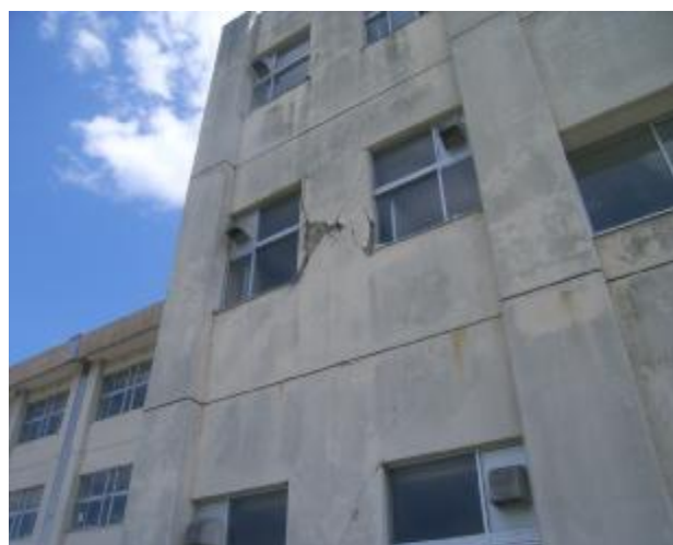
鉄筋コンクリート造の被害状況 (柱のせん断破壊によるひび割れ・剥落)
