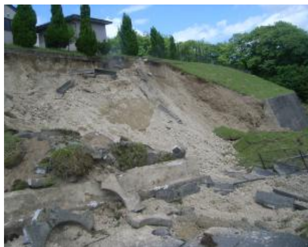
法面の被害状況(滑落・崩壊)
