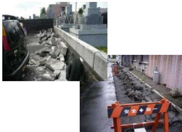
写真8 ブロック塀等の被害 (上；コンクリートブロック塀 下；石塀)
