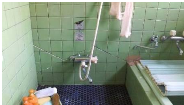
写真3 半壊した住宅の被害 (浴室の壁タイルにひび割れ)
