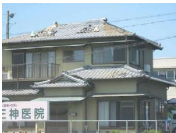
写真5 瓦屋根の被害状況
