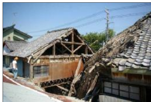
写真7 半壊した倉庫
