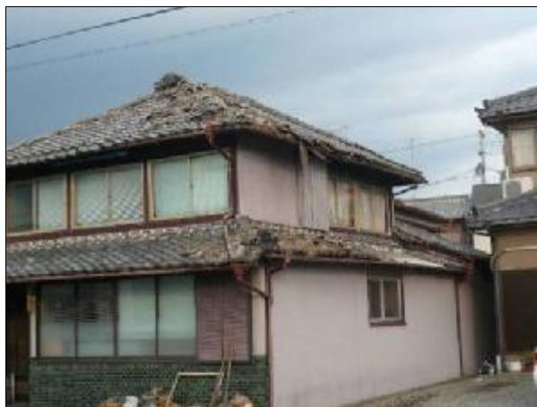
写真4 瓦屋根の被害状況
