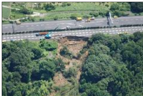
写真2 東名高速道路の盛土崩落
