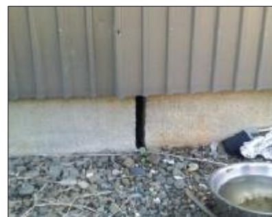
住宅基礎の被害
