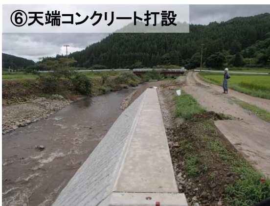
護岸上部からの水を防ぎます
