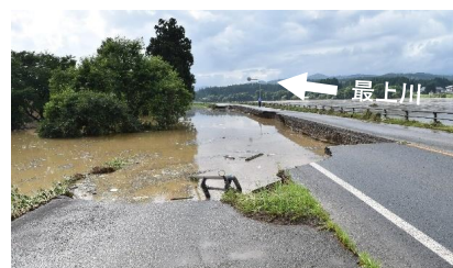
【国】最上川44.3k付近(堤防欠損状況)
