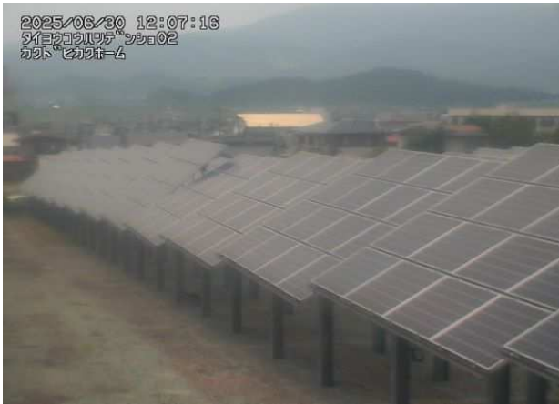
令和7年6月30日 12:07 太陽光発電所の状況
