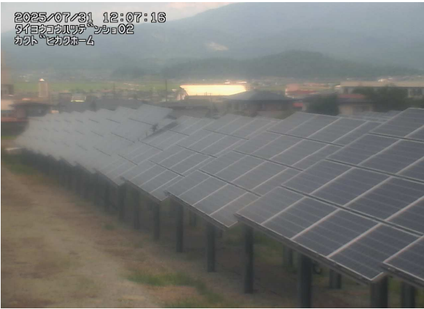
令和7年7月31日 12:07 太陽光発電所の状況
