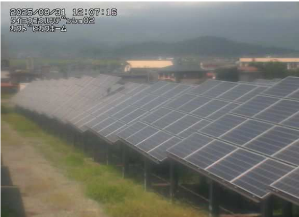
令和7年8月31日 12:07 太陽光発電所の状況
