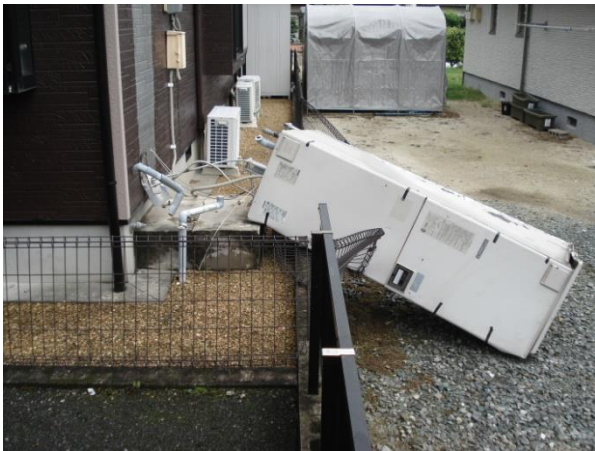
給湯設備被害状況
