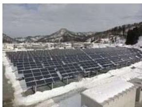
県営太陽光発電所
