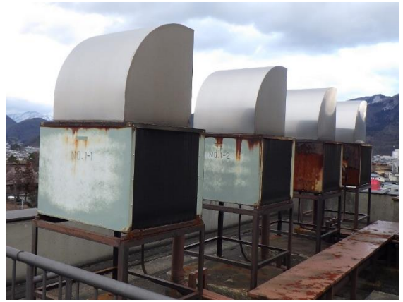
老朽化が進む建物附帯設備
