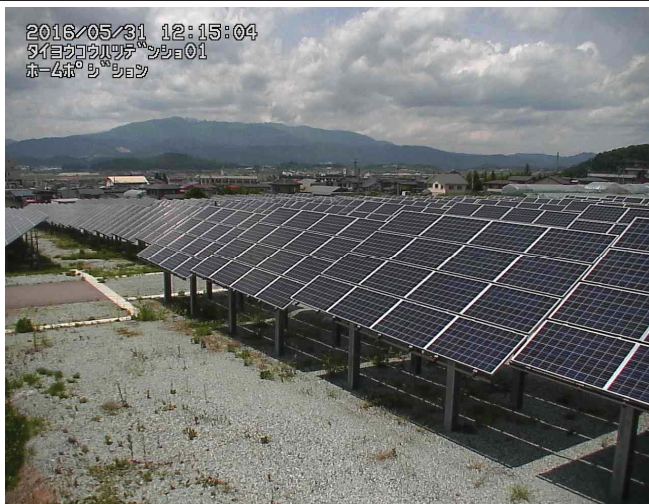
平成28年5月31日 12:15 太陽光発電所の状況
