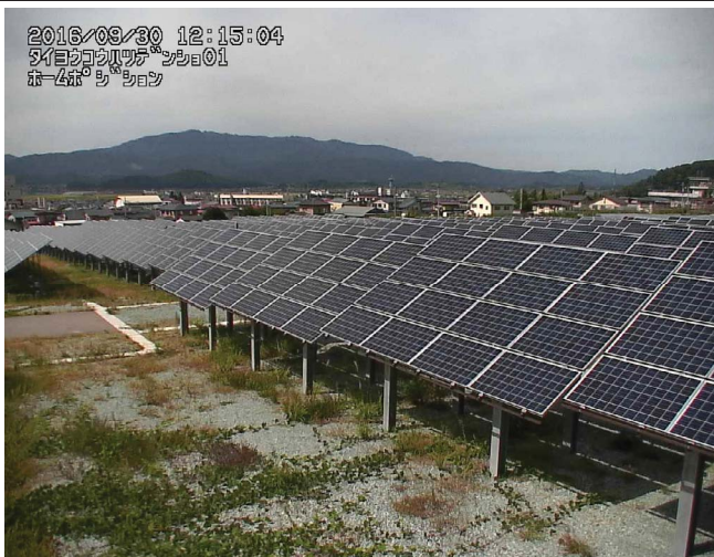
平成28年9月30日 12:15 太陽光発電所の状況
