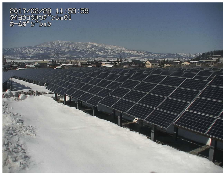
平成29年2月28日 12:00 太陽光発電所の状況
