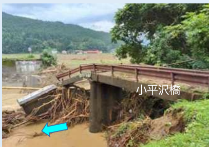
被災時（撮影：R6.7月）
