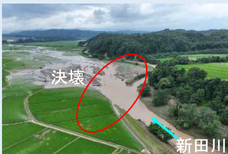
被災時（撮影：R6.7月）
