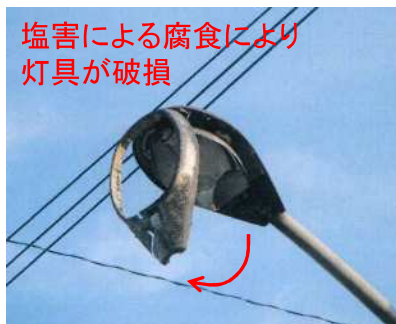
照明灯更新前
