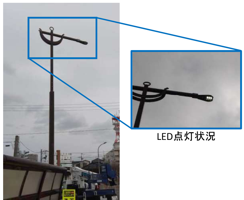
照明灯更新後
