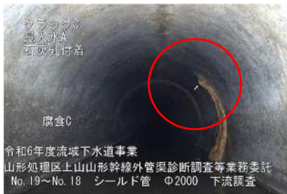
緊急度Ⅰ：劣化ランクA (浸入水A、石灰乳付着)
