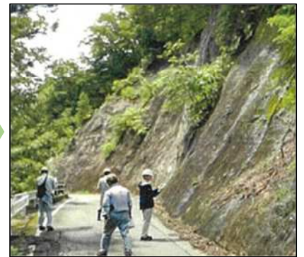
現地にて変状部を効率的に点検
