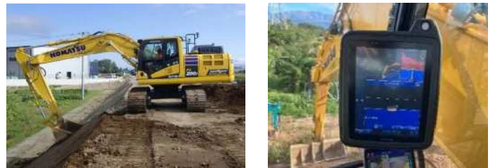
ICT活用工事の施工例 (3次元データを活用した盛土工事)
