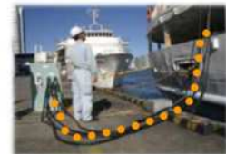
電力供給設備
