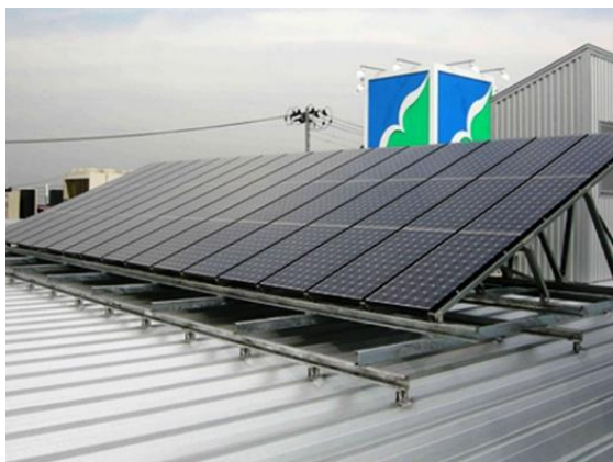
店舗屋根に設置する太陽光発電システム
