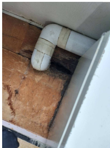
【暖房設備】 管を通しての床の穴あき
