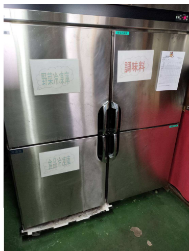
【冷凍冷蔵庫】 冷凍冷蔵機能の低下
