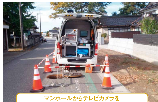
管路施設の耐震化工事「ハットリング工法」 （マンホール浮き上がり防止）
