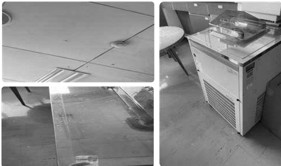
本館4階の蛍光X線分析室 天井からの水漏れ（8月1日監査人撮影）
